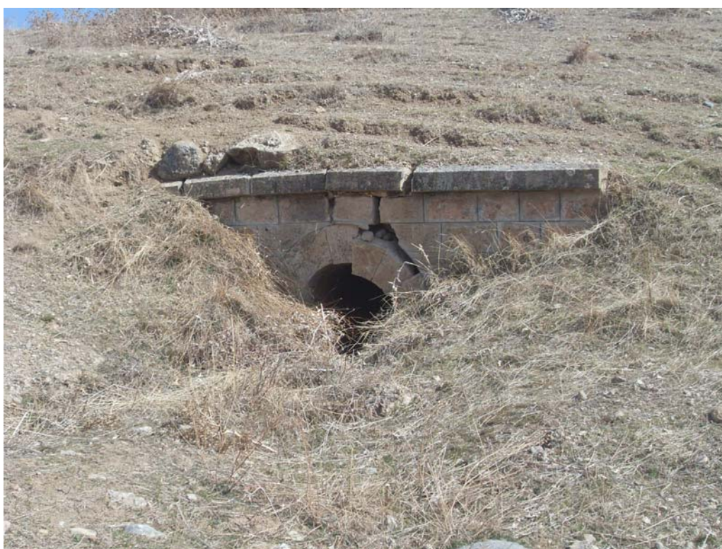
Figura 17: Terraplén del estribo lado Baza. Obra de paso de la Acequia de la Mujer, arruinada. Evidencia del movimiento del terraplén.
