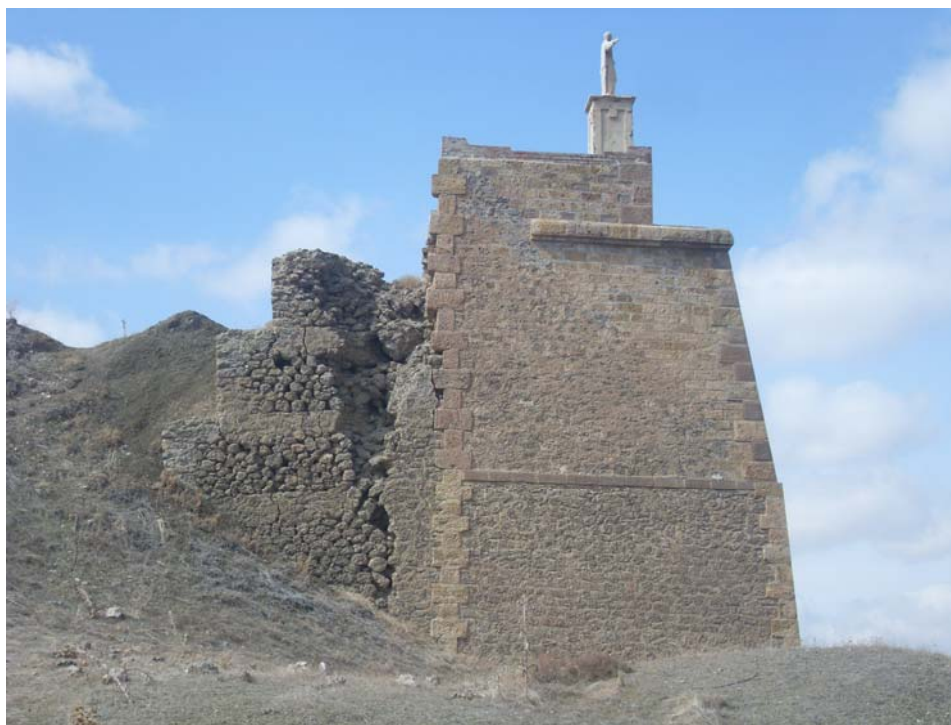
Figura 15: Restos del puente en Gor. Antiguo estribo del lado Guadix. La erosión del terraplén ha dejado a la vista el contraestribo.
